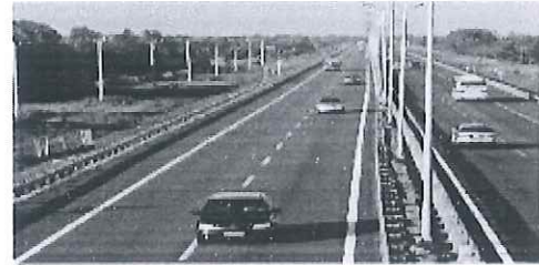
Hình ảnh 2: Cao tốc Tp. Hồ Chí Minh - Trung Lương. Thi công các đường và cầu trên tuyến (2005-2008)
